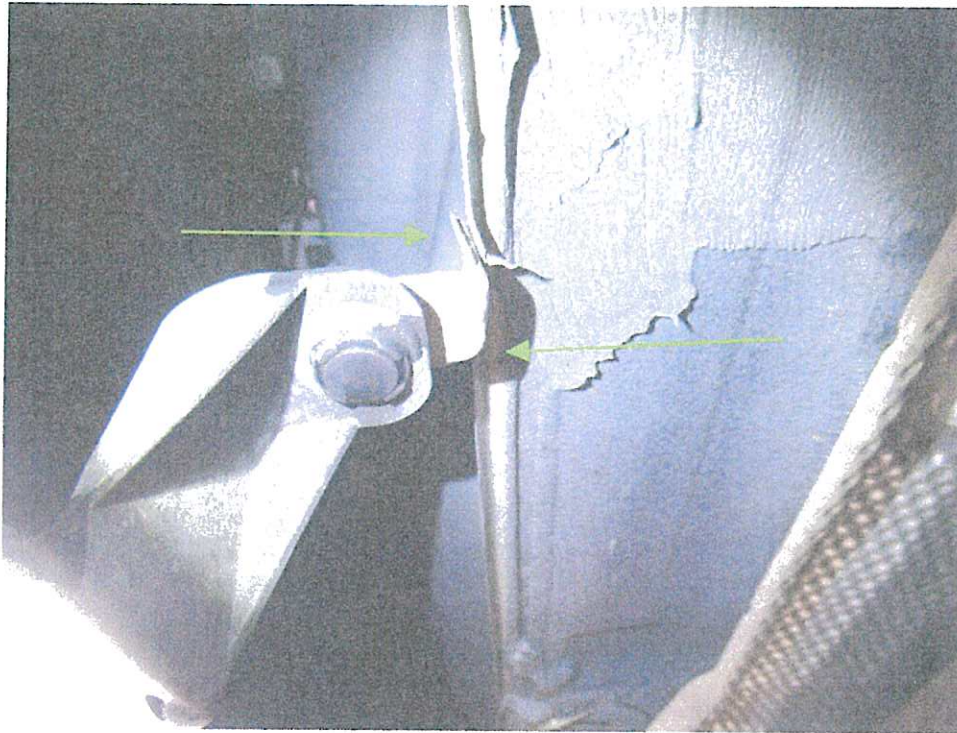
Bild 21 : Abschlussblech durch Anstoß deformiert
