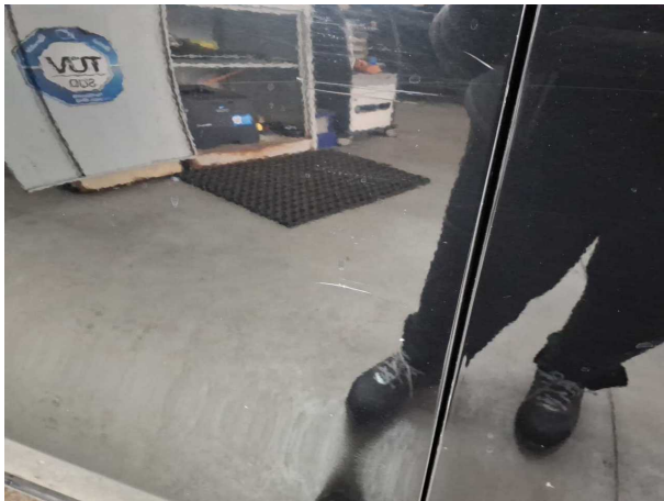
Schiebetür rechts: Schiebetür mit Glasscheibe - Kratzer - lackieren
