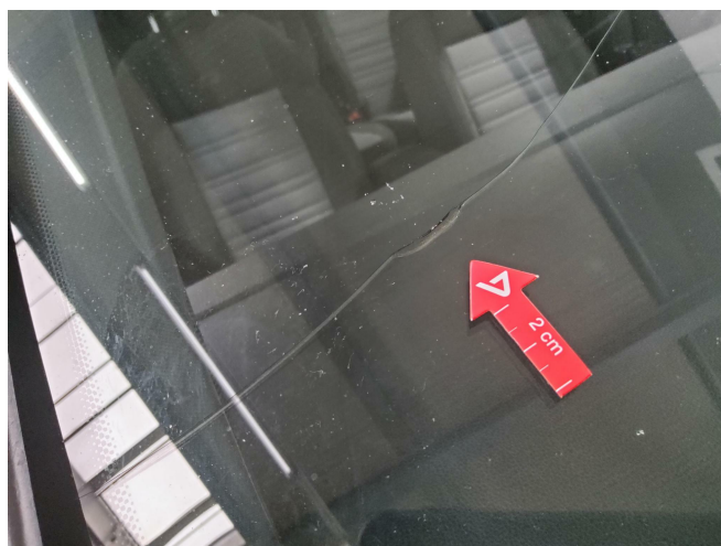
Bild 2: Außen, Frontscheibe - im Randbereich , Steinschlag mit Rissbildung , erneuern
